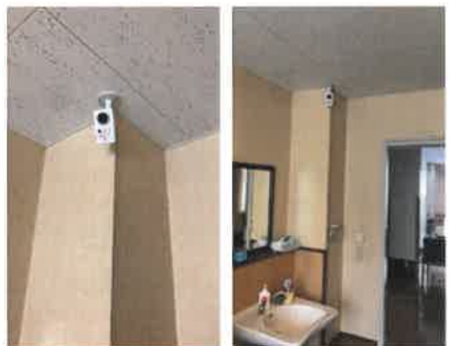
見守り機器の設置状況
